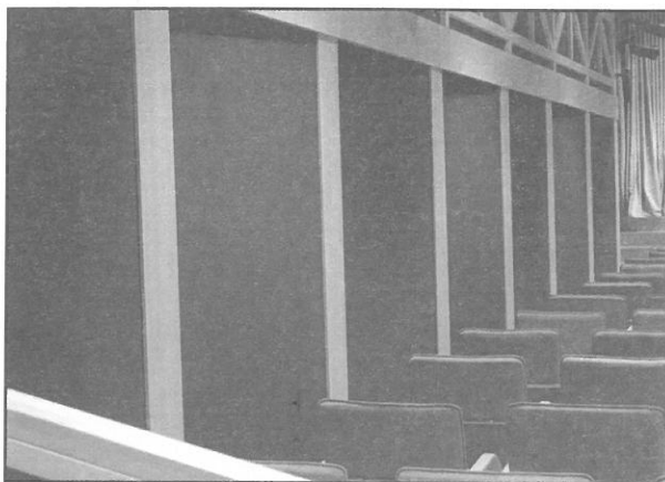
A Fő utca felőli oldalfal zajszigetelő felülete
