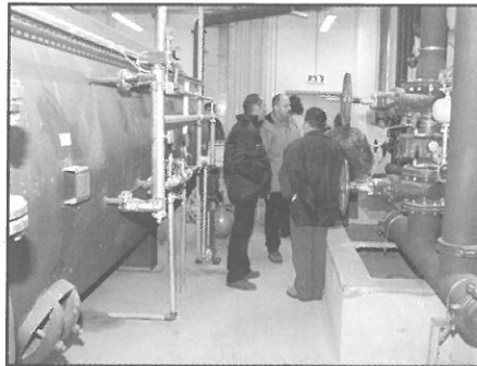
Automata tűzoltó-berendezés a Liegl-Dachser Kft. raktártelepén
